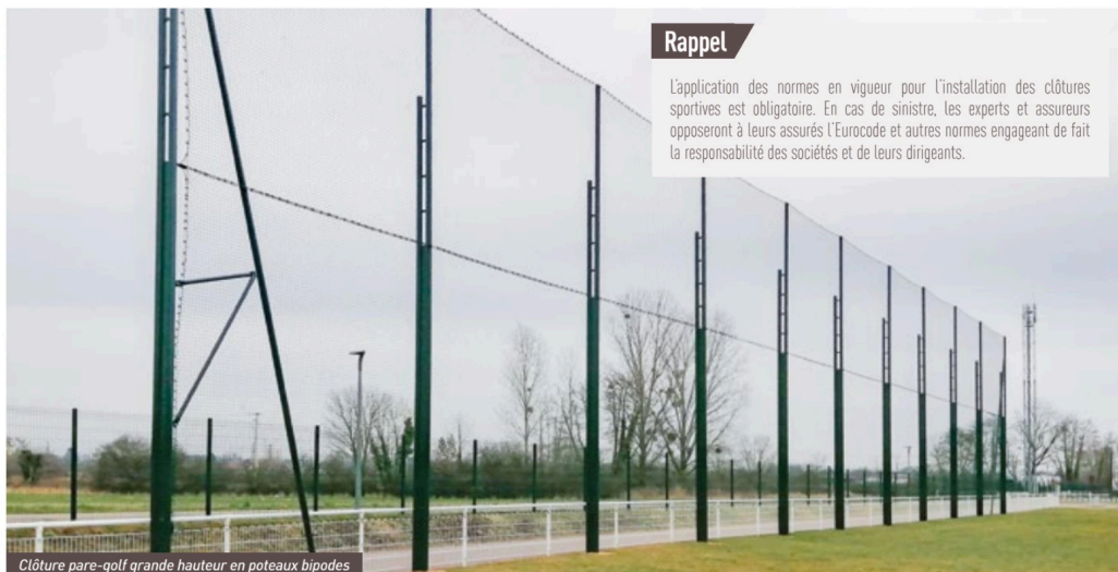
Clôture pare-golf grande hauteur en poteaux bipodes
